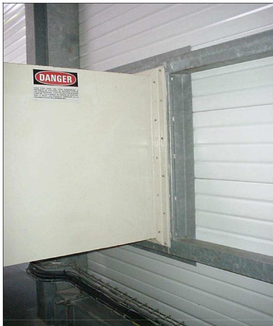
Vue intérieure du hall n°2 : Sortie d'un événement de filtre
