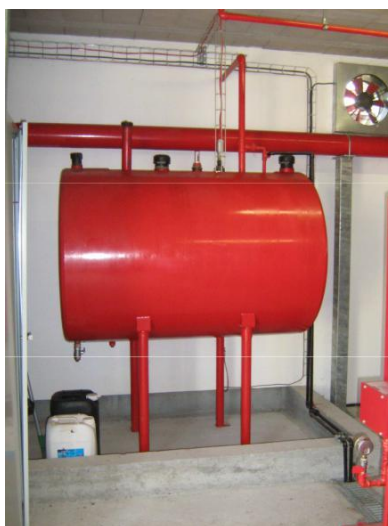
Cuve de fioul
