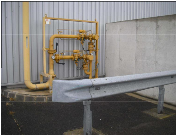
Barrière de protection des canalisations d'arrivée de gaz.
