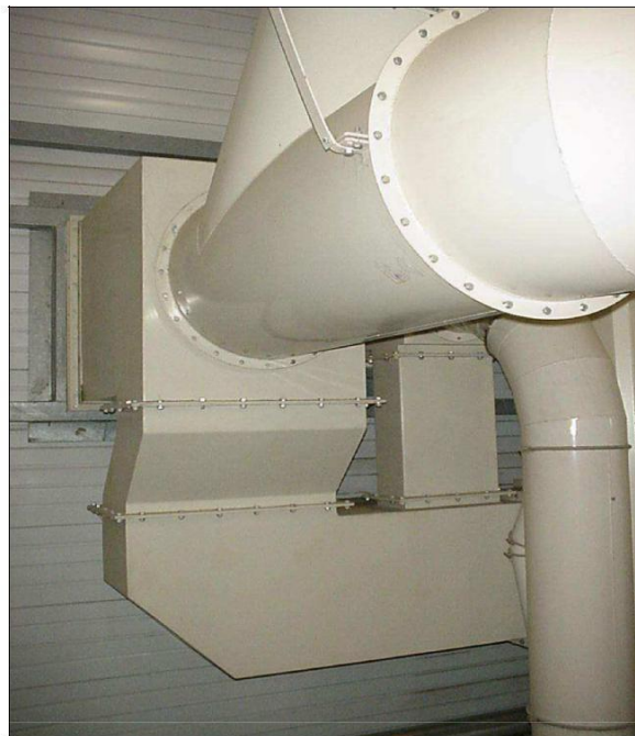
Vue intérieure de la tour de réception : Event sur circuit d'aspiration avant filtre
